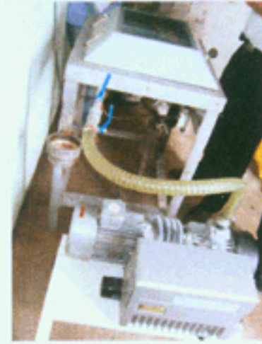
ภาพที่ 27 ปัมดูดอากาศ
